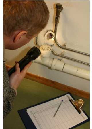
Bygningen inspiseres og hull og sprekker som dyr kan komme gjennom må tettes (Foto: H. Heggen, Folkehelseinstituttet)
