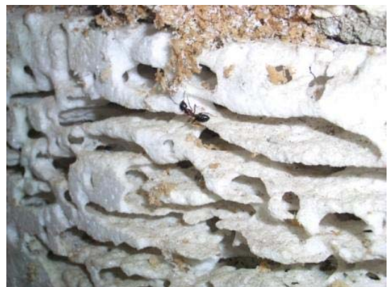
Bilde 2: Skade i ekspandert polystyren forårsaket av storkmaur ( Camponotus ligniperda ).
