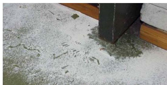
Figur 2. Spor etter brunrotte i mel. Foto: Reidar Mehl
