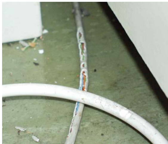
Figur 3. Rottegnag på strømledninger øker faren for kortslutning og brann. Foto: Reidar Mehl.
