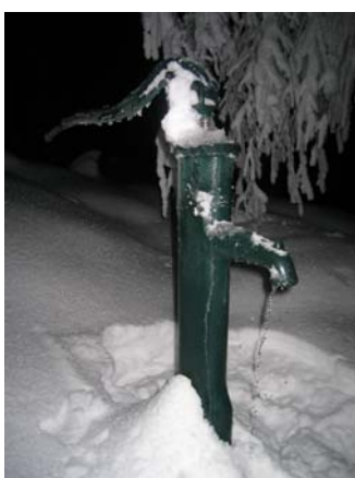
Håndpumpe for borebrønn i fjell (foto, Jens Erik Pettersen)
